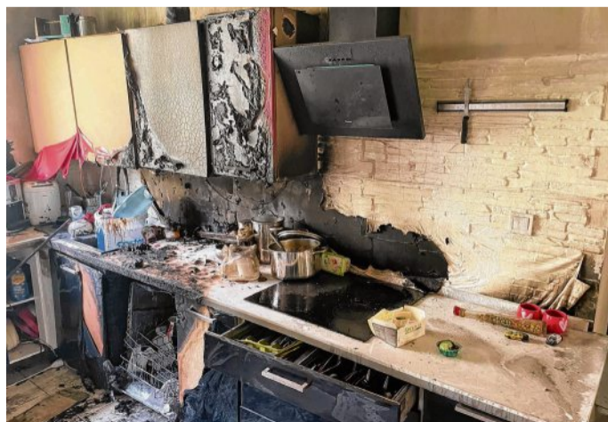
Die Küche des Hauses ist durch den Geschirrspüler-Brand stark in Mitleidenschaft gezogen worden.
