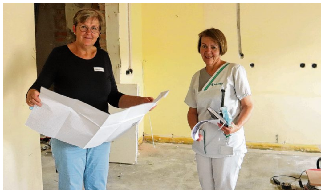
Noch gehört auch für Christiane Schumacher (l.), Technische Leiterin der Asklepios Klinik Pasewalk, und Simone Hanel, Leitende Hebamme, etwas Vorstellungsvermögen dazu, wenn es darum geht, wie die neuen Kreißsäle aussehen werden. Der Bereich wird komplett saniert. FOTO: FRED LUCIUS
